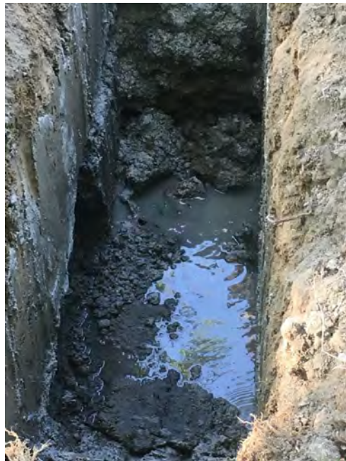
Photo 51. Sondage GAL3-5_T8N (rebouchage au fur et à mesure, non tenue des parois de la tranchée)
